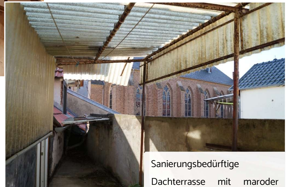
Sanierungsbedürftiges Zimmer im Dachgeschoss (diverse Feuchtigkeitsschäden).
